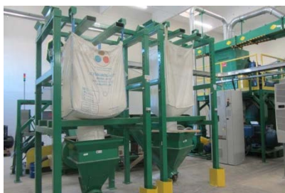
On rajoute des additifs pour que la ouate résiste au feu et à la moisissure © Radio France - Marion Bastit
